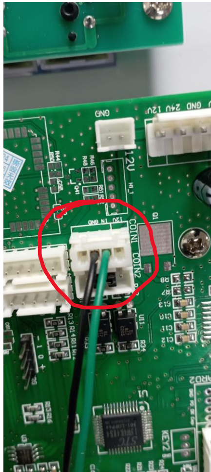
Figura 20 – Cabo auxiliar conectado a placa de controle, cabo verde mostra a via pulsos e cabo preto mostra a via GND
